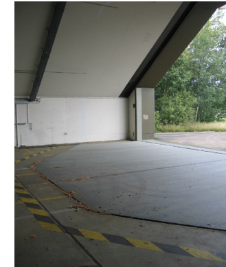
Hydraulische deur in vliegtuig-shelters scharniert vanuit de vloer.
