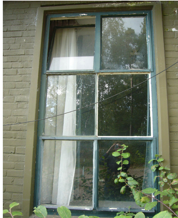
Camouflage architectuur, vensters is traditionele vorm, de kozijnen zijn van beton en de ramen van staal ter bescherming tegen oorlogsgeweld.
